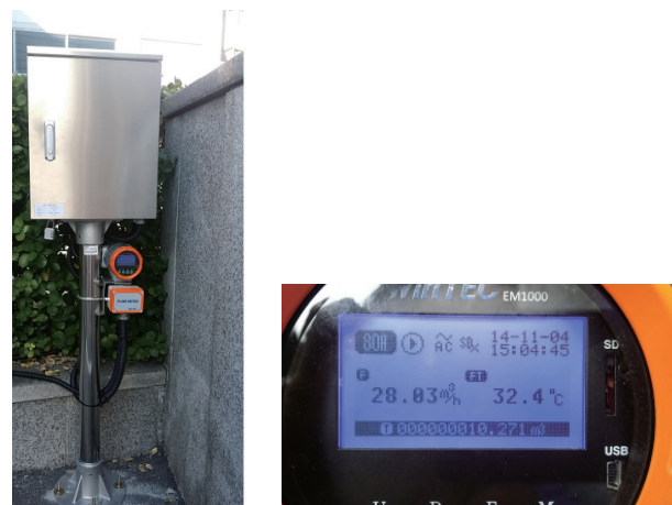
그림 7. 설치가 완료된 메인 컨트롤함과 유량확인용 LCD창
